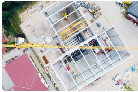
oberer Bereich: vollautomatisches Brennstofflager / Querbau unten: Kesselanlage und Turbine
