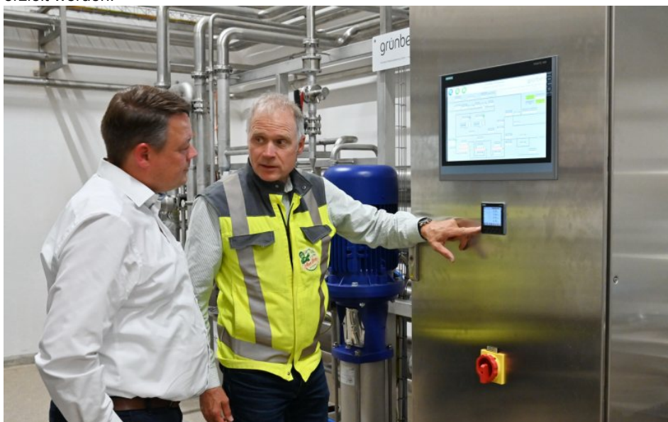
Auerbräu-Geschäftsführer Thomas Frank (re.) und Dominik Wiedenbauer, Branchenleiter bei Grünbeck, besprechen Details der Anlagensteuerung (Bild: Grünbeck).
