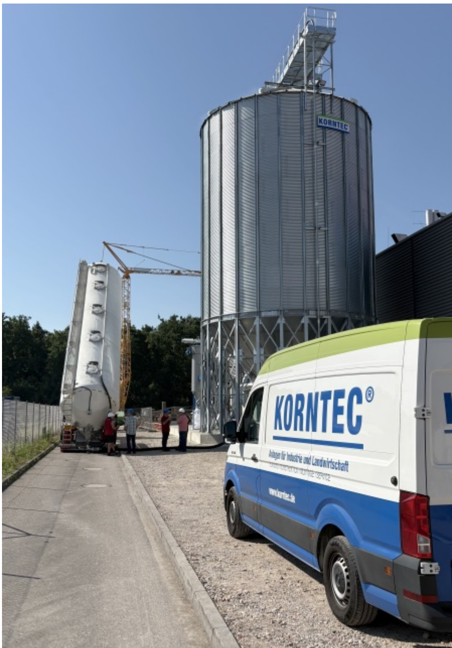
Die neue Siloanlage bietet Platz für 3000 t Bio-Sojabohnen (Bild: Korntec).
