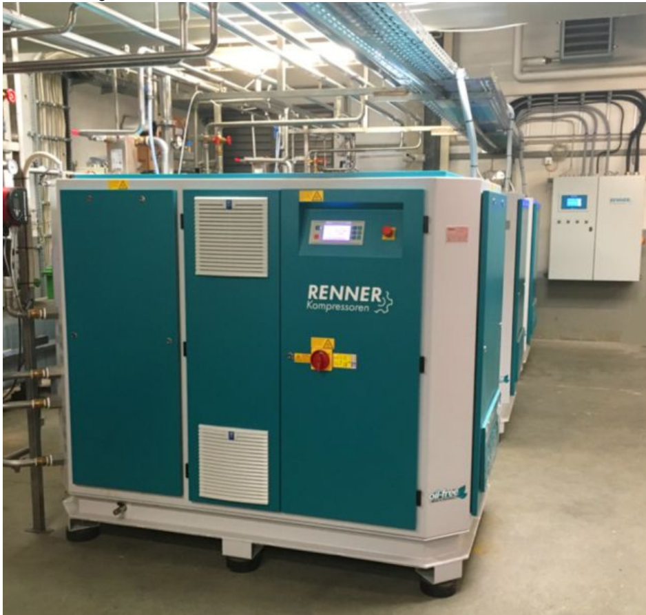
Die Anlage bei Sinziger im Betrieb. Bild: Renner
