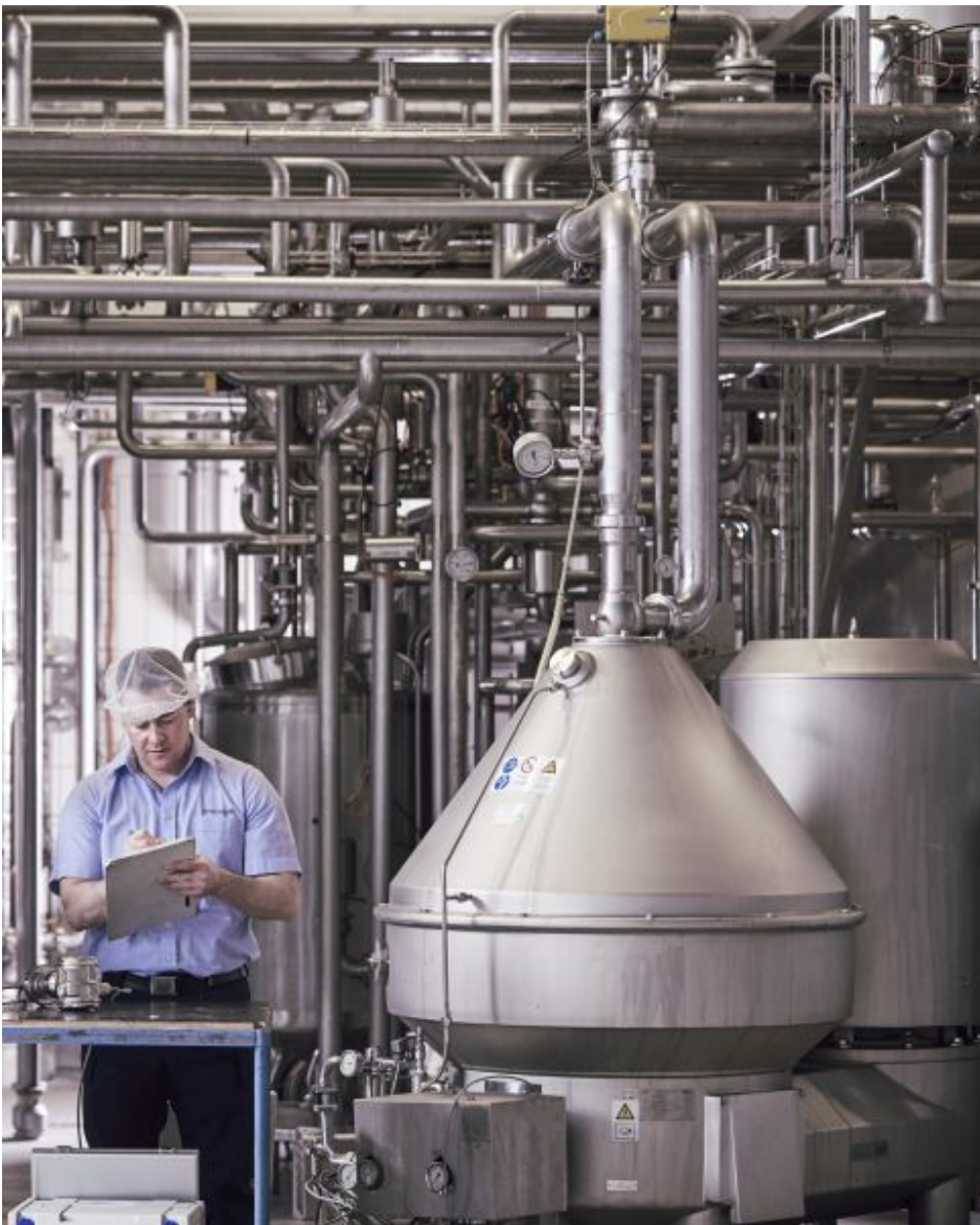
Servicetechniker Jürgen Sittenberger von Endress+Hauser während des Serviceeinsatzes bei den Milchwerken Schwaben. Bild: Endress+Hauser
