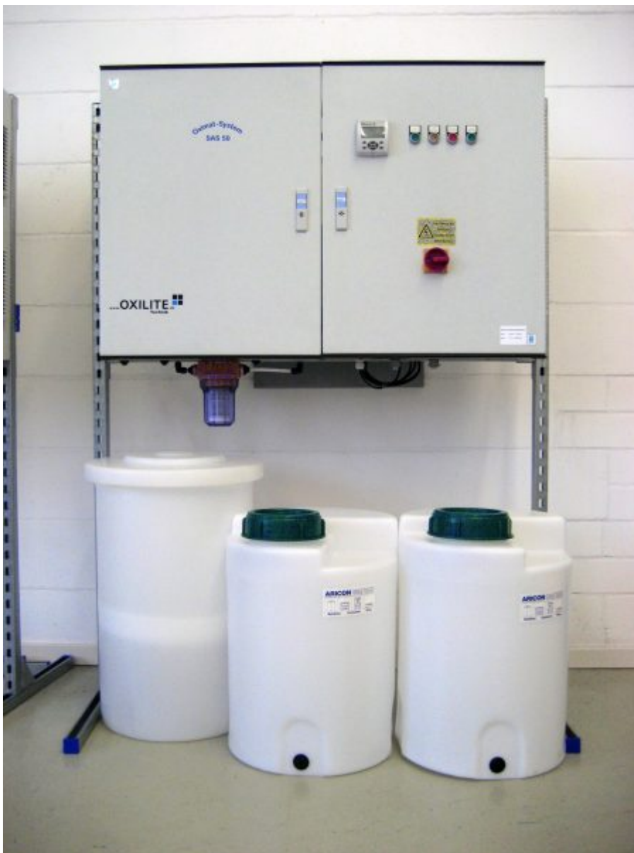
Die Anlage zur Produktion des Desinfektionsmittels nutzt wartungsarme Schlauchpumpen. Bilder: Inno Waterclean
