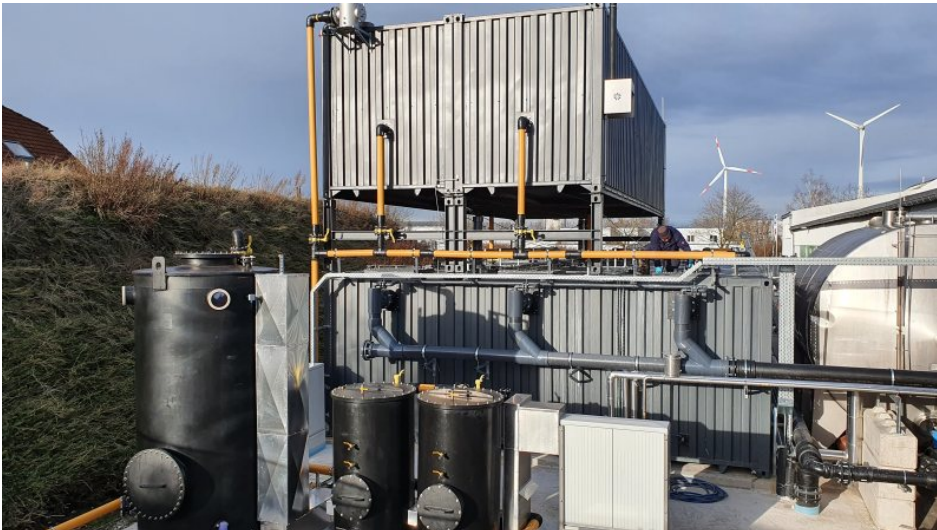
Anlagenverbund zur anaeroben Abwasserbehandlung mit Gasspeicherung und Gasaufbereitung (Bild: Flexbio).
