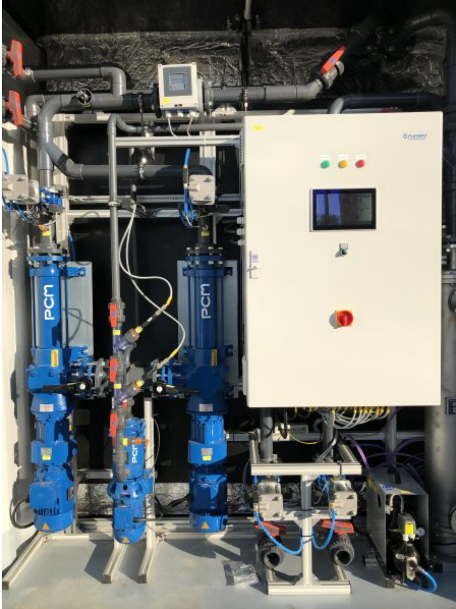
Technikraum einer anaeroben Abwasservorbehandlung (Bild: Flexbio).
